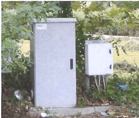
QUADRO ELETTRICO:Q76 STRADA SS PADANA
