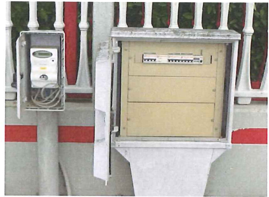
QUADRO ELETTRICO:Q48 VIA BARATELLO
