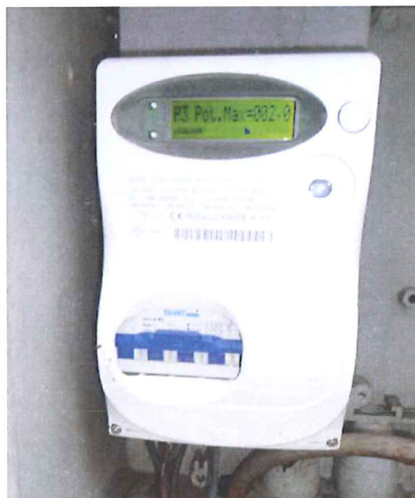
QUADRO ELETTRICO:Q54 VIA MARINI
