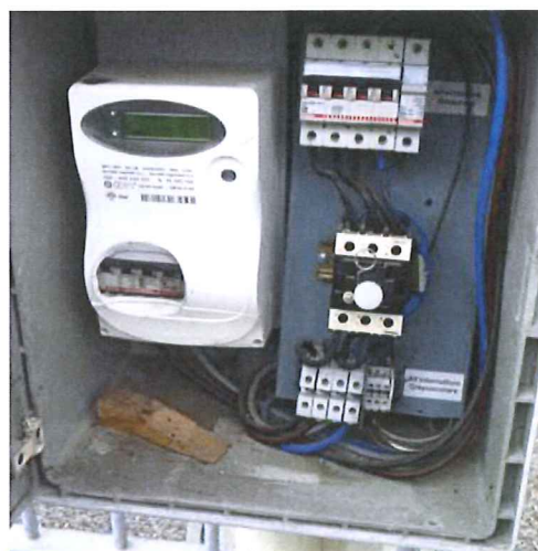
QUADRO ELETTRICO:Q08 VIA GAVARDINA NORD
