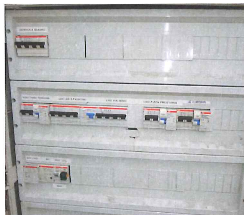
QUADRO ELETTRICO:Q63 VIA SANTI FAUSTINO E GIOVITA
