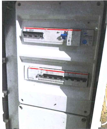
QUADRO ELETTRICO:Q10VIA ALERAMO
