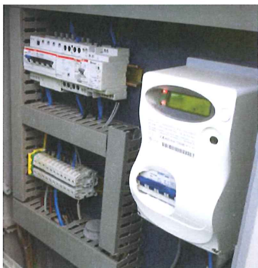
QUADRO ELETTRICO:Q05 VIA STATALE CASCINA CAMPAGNA
