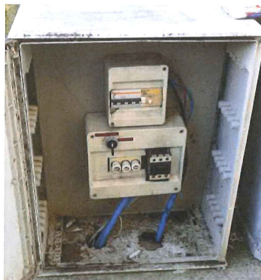
QUADRO ELETTRICO:Q21 VIA SAN MARTINO
