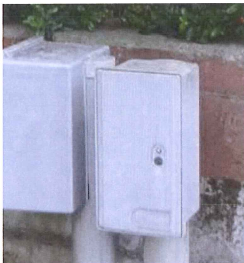
QUADRO ELETTRICO:Q53 VIA DUCA D'ABRUZZI
