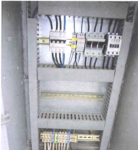
QUADRO ELETTRICO:Q29 VIA GALILEI
