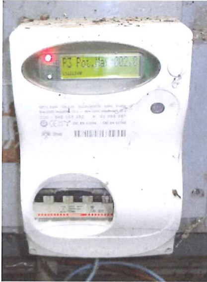
QUADRO ELETTRICO:Q43 VIA DELLA FILANDA
