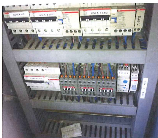
QUADRO ELETTRICO:Q07 VIA CAVICCHIONE SOPRA
