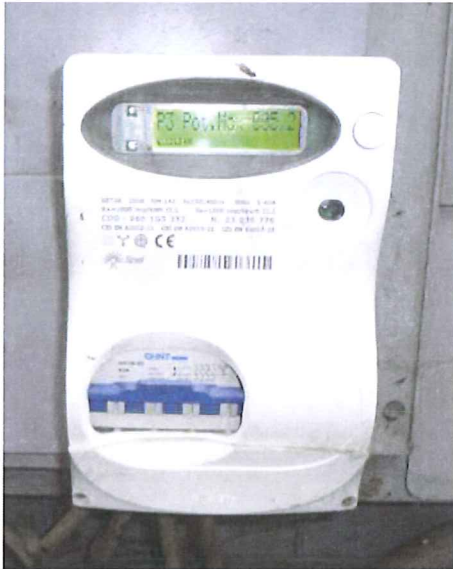
QUADRO ELETTRICO:Q69 VIA SCHIANNINI
