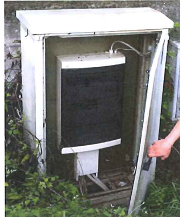
QUADRO ELETTRICO:Q02 ROTATORIA SS PADANA
