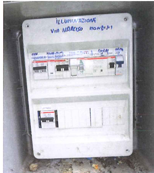
QUADRO ELETTRICO:Q70 VIA MONDINI
