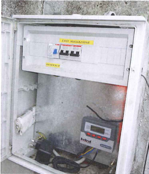
QUADRO ELETTRICO:Q39 VIA PALESTRO
