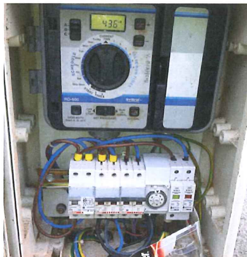
QUADRO ELETTRICO:Q17 VIA F.BIANCHI
