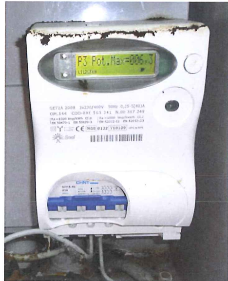
QUADRO ELETTRICO:Q44 VIA DELLA FILANDA
