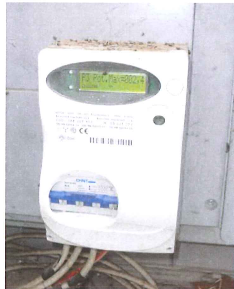
QUADRO ELETTRICO:Q46 VIA BARATELLO
