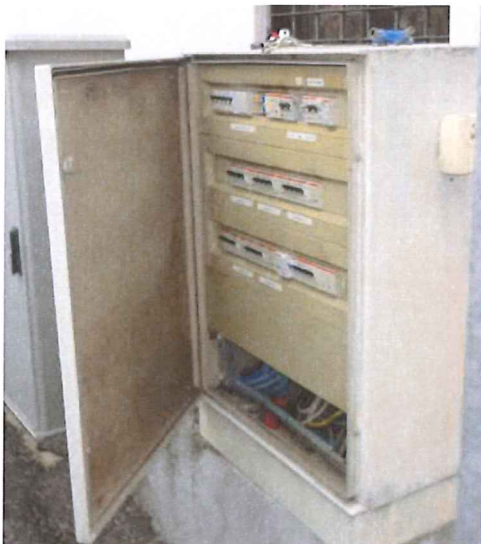
QUADRO ELETTRICO:Q45 VIA DELLA
