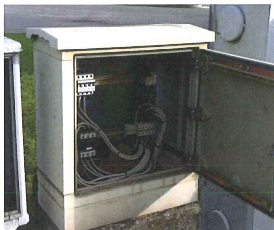
QUADRO ELETTRICO:Q06 VIA ALERAMO
