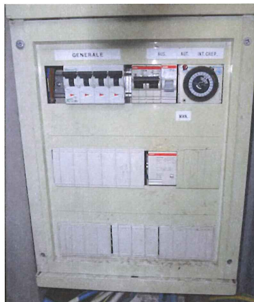
QUADRO ELETTRICO:Q34 VIA CAIROLI
