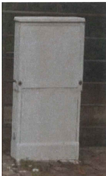
QUADRO ELETTRICO:Q33 VIA MATTEOTTI
