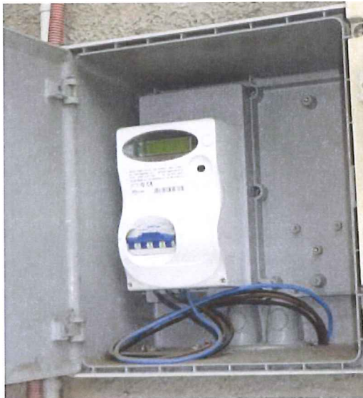
QUADRO ELETTRICO:Q37 VIA XX SETTEMBRE
