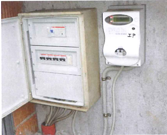
QUADRO ELETTRICO:Q35 VIA MATTEOTTI
