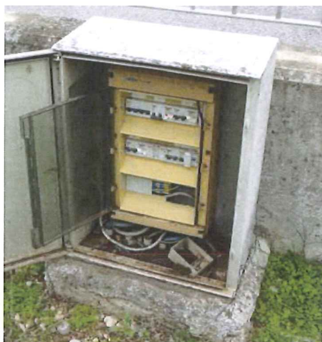
QUADRO ELETTRICO:78 STRADA COMUNALE DEL ROVADINO
