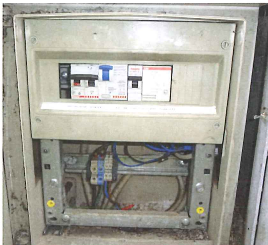
QUADRO ELETTRICO:Q31 VIA CIMITERO
