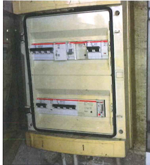
QUADRO ELETTRICO:Q24 VIA CAVOUR
