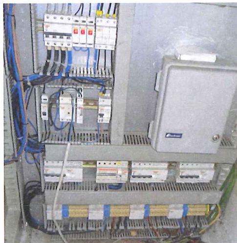
QUADRO ELETTRICO:Q61 VIA ROVADINO
