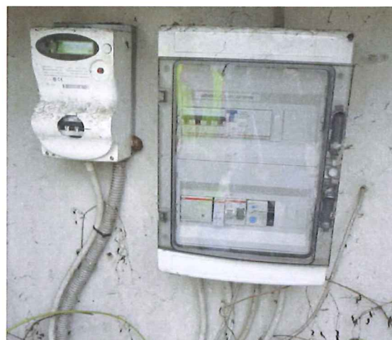
QUADRO ELETTRICO:Q79 STRADA COMUNALE DEL ROVADINO
