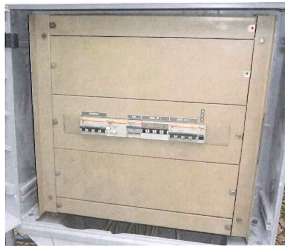
QUADRO ELETTRICO:Q32 VIA PRIMO MAGGIO
