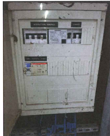
QUADRO ELETTRICO:Q12 VIA BRESCIA
