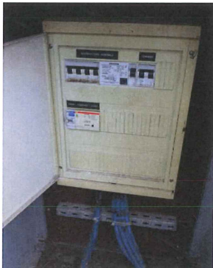
QUADRO ELETTRICO:Q13 VIA BRESCIA
