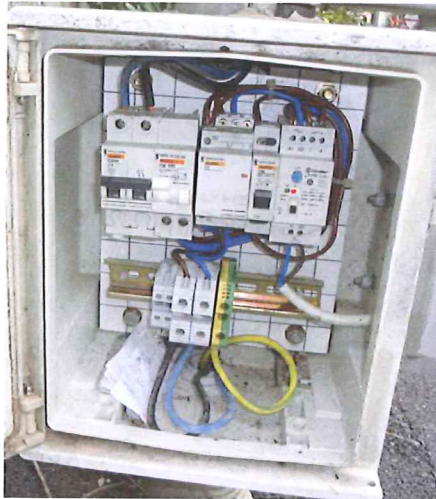
QUADRO ELETTRICO:Q47 VIA VITTORIO ALFIERI
