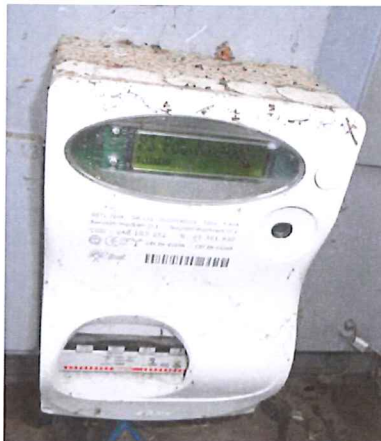
QUADRO ELETTRICO:Q50 VIA BASSOTTI
