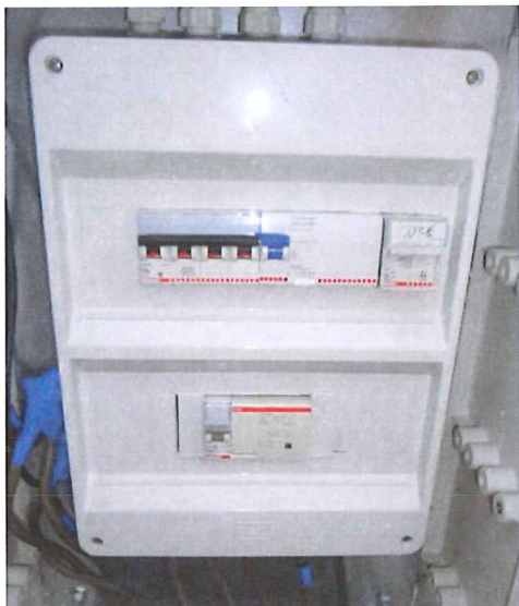
QUADRO ELETTRICO:Q59 VIA VERDI
