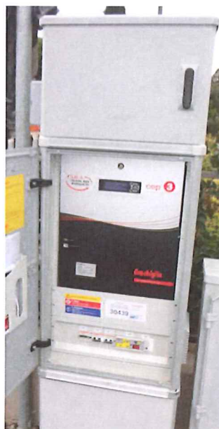
QUADRO ELETTRICO:Q81 VIA MATTEOTTI
