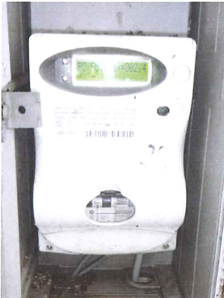
QUADRO ELETTRICO:Q71 VIA BERLINGUER
