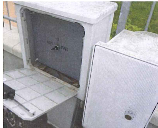
QUADRO ELETTRICO:Q72 VIA BERLINGUER
