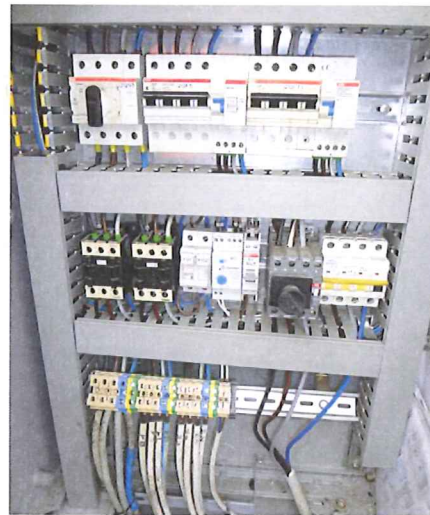
QUADRO ELETTRICO:Q30 VIA GALILEI
