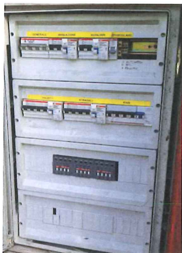
QUADRO ELETTRICO:Q18 VIA BIANCHI
