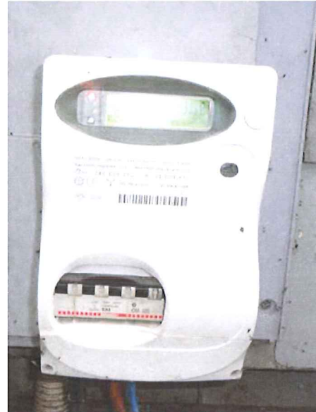
QUADRO ELETTRICO:Q74 VIA MORELLI
