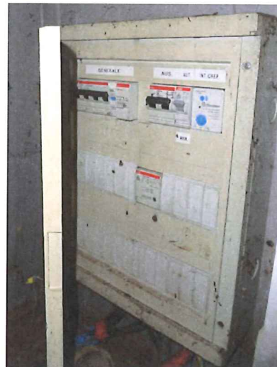
QUADRO ELETTRICO:Q51 VIA BASSOTTI
