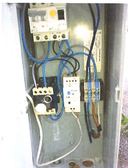
QUADRO ELETTRICO:Q20 VIA MARCO AGOSTI
