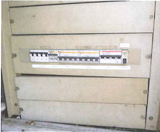
QUADRO ELETTRICO:Q27 VIA MORIAGA E BEGATTA
