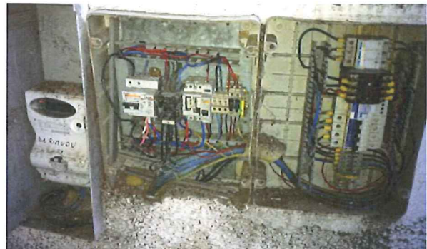
QUADRO ELETTRICO:Q26 VIA GUERZONI
