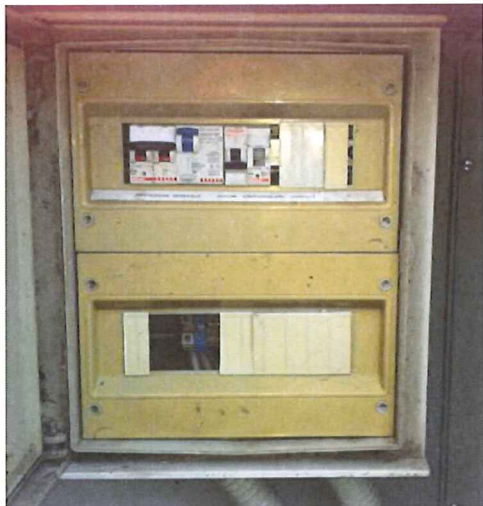
QUADRO ELETTRICO:Q03 VIA BRESCIA
