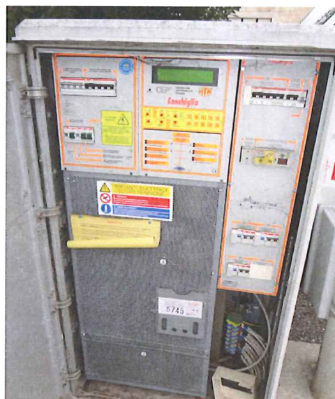
QUADRO ELETTRICO:Q67 VIA STATALE
