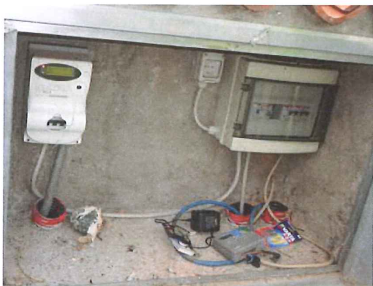
QUADRO ELETTRICO:Q64 VIA PATRIOTI
