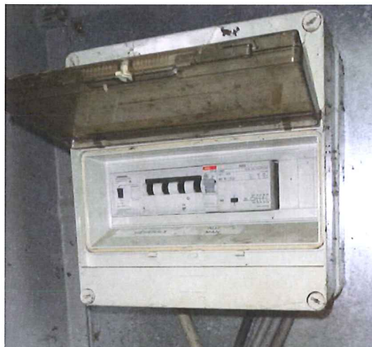
QUADRO ELETTRICO:Q14 VIA GAVARDINA DI SOTTO
