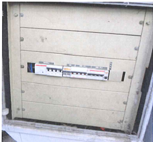
QUADRO ELETTRICO:Q16 VIA CAVOUR
