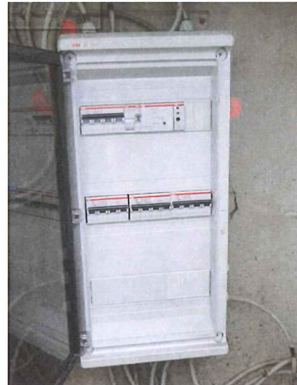
QUADRO ELETTRICO:Q77 ROTATORIA SS PADANA
