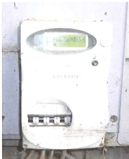
QUADRO ELETTRICO:Q57 VIA CALRO ALBERTO
