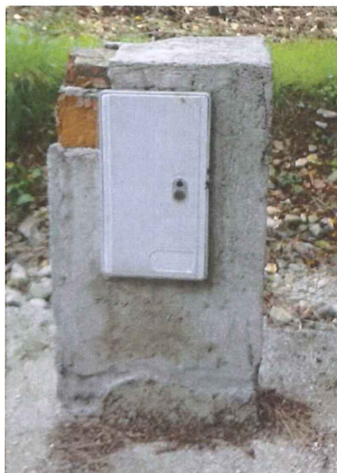
QUADRO ELETTRICO:Q82 STRADA CHIESA S.ANNA
