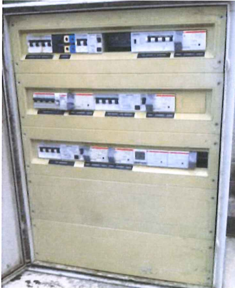
QUADRO ELETTRICO:Q23 VIA CROCE S.STEFANO
